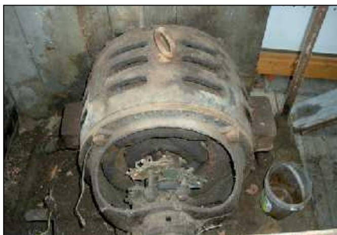
An diesem Motor ist noch viel Arbeit
